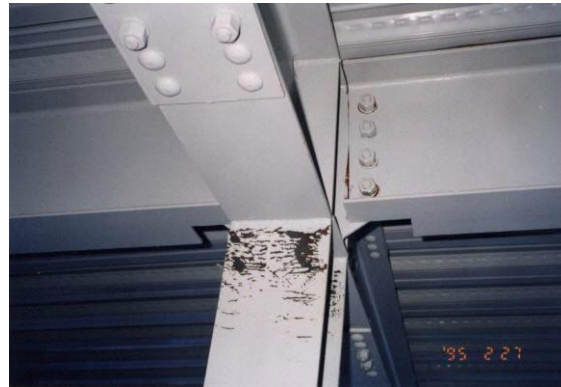
写真2-2 柱頭の座屈による塗料の剥落(Bランク)
