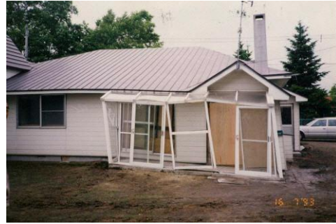
写真 1-2 建物の不同沈下(Cランク)
