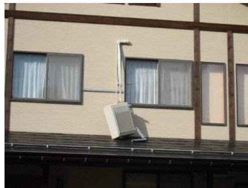
写真1-18 エアコン室外機の落下危険(Cランク)
