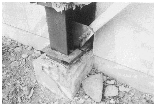
写真2-7 柱脚コンクリートの部分破壊
