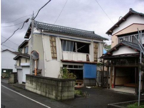
写真1-16 サイディングの落下(Cランク)
