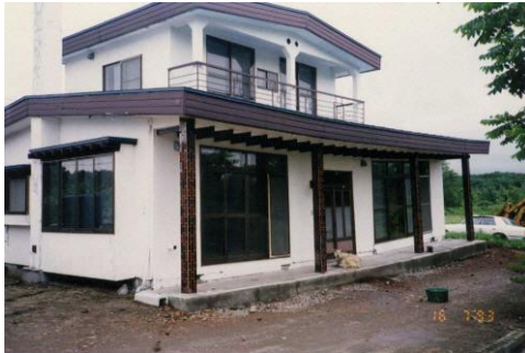
写真 1-1 建物の不同沈下(Bランク)
