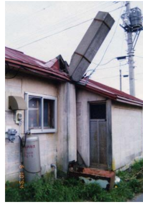
写真1-21 煙突の転倒危険(Cランク)
