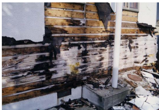
写真1-8 下地材の腐朽(Bランク)
