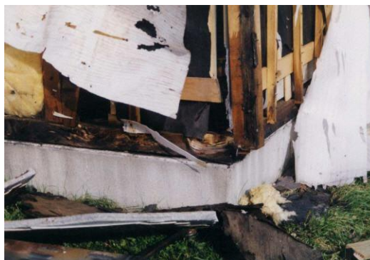
写真1-9 土台、柱の腐朽(Cランク)
