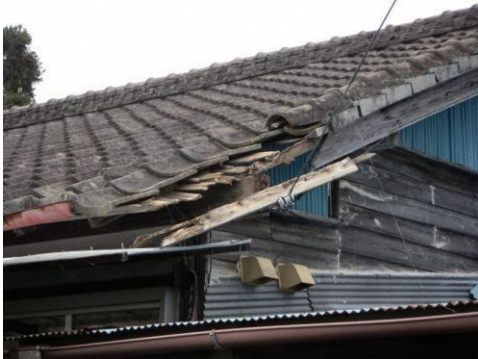
写真1-10 屋根瓦の落下損傷(Bランク)
