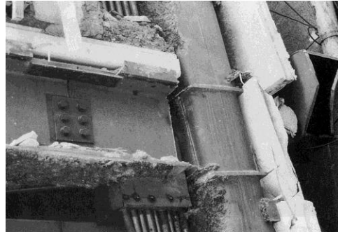
写真2-5 梁仕口部の溶接部分の破断
