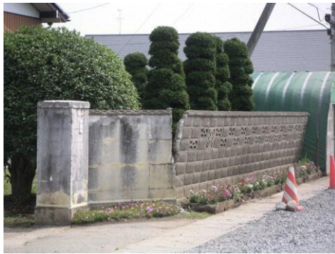
写真1-20 ブロック塀の転倒危険(Cランク)
