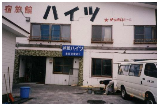
写真1-6 外壁の被害(Bランク)
