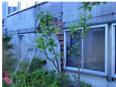
写真1-15 モルタル壁の剥落(Bランク)
