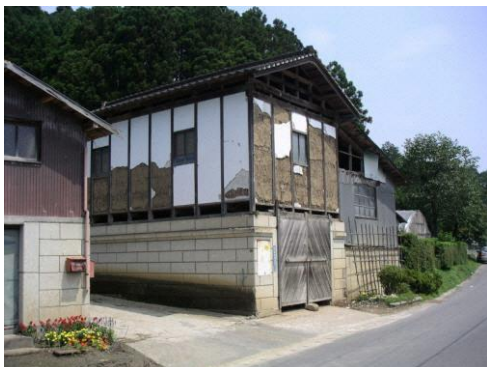
写真1-14 土壁の剥落(Cランク)
