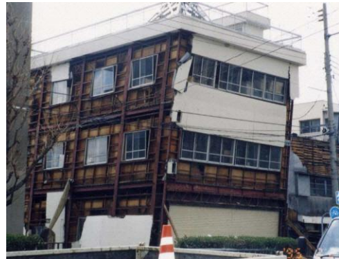
写真 2-1 傾斜による外装材の剥落
