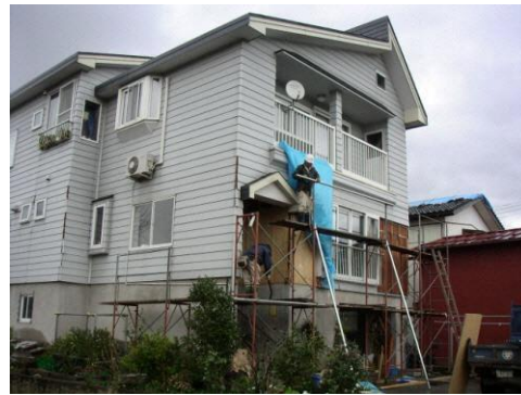
写真1-17 サイディングの損傷(Bランク)
