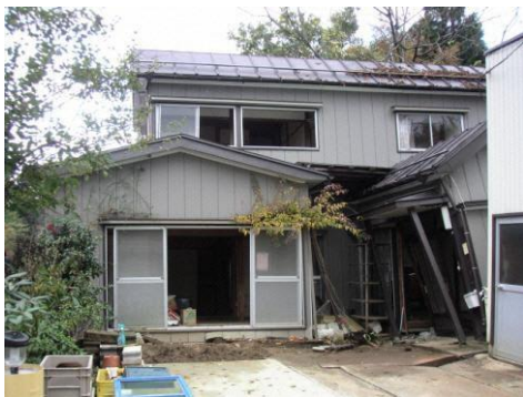
写真1-12 窓枠の歪み(Bランク)
