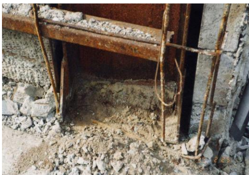
写真2-8 柱と胴縁の腐食(Cランク)
