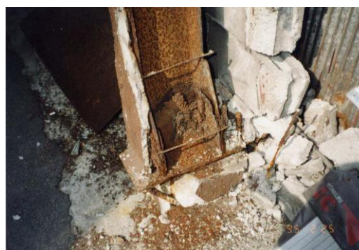
写真2-9 柱脚の腐食(Cランク)
