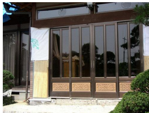
写真1-13 玄関戸の歪み(Bランク)
