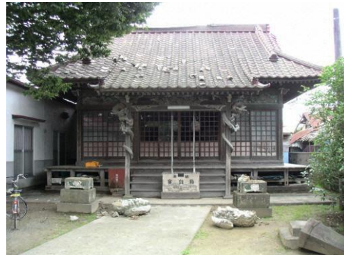
写真1-11 棟瓦のズレ、損傷(Cランク)
