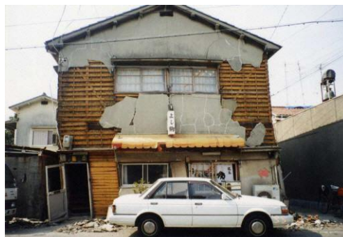
写真1-7 外壁の被害(Cランク)
