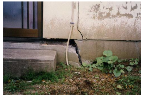
写真1-4 基礎の破断(Cランク)
