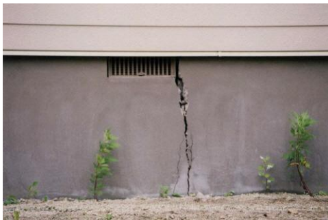
写真1-3 基礎の亀裂(Bランク)
