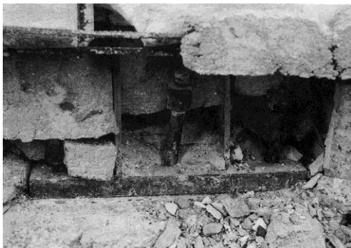
写真2-6 柱脚のアンカーボルトの引き抜け
