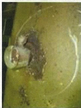
屋根構体腐食
