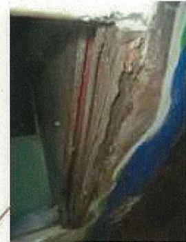
側引戸部腐食
