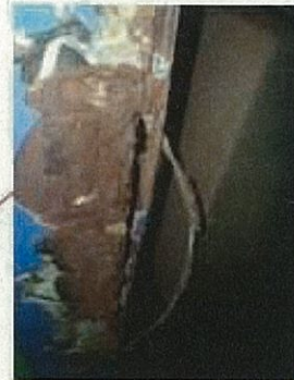
側構体部腐食
