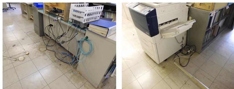
露出するデジタル機器等の配線類
