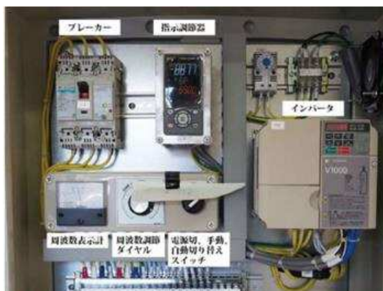
図4・21 プランジャーポンプ制御盤
