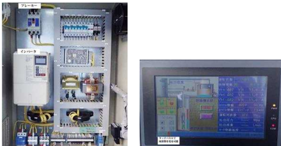
図 4-19 CBM ポンプ制御盤 (左) とタッチパネル (右)
